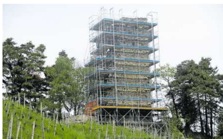
In den kommenden Monaten wird die zwischen St. Margrethen und Walzenhausen gelegene Burgruine Grimmenstein umfassend saniert.
